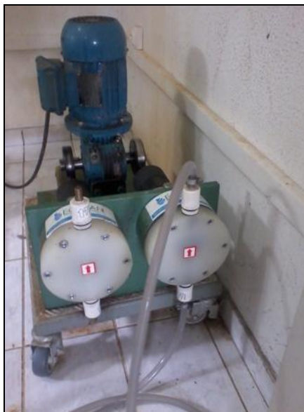
Figura 2 – Bomba de recirculação utilizada no experimento
