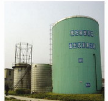
UASB 产沼气工程 (400m³)
