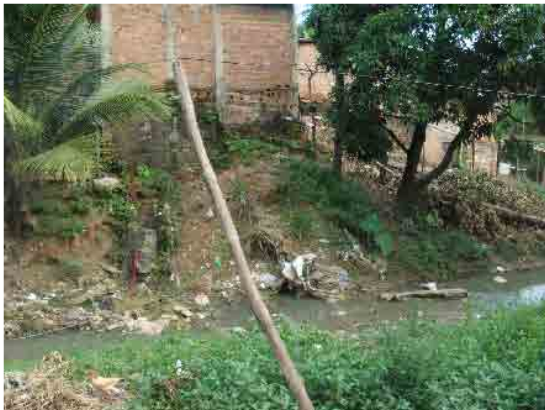
Ilustração 12: Construções irregulares nas margens do rio Reginaldo, ameaçadas por desmoronamento devido as enchentes que provocam deslizamento de barreiras Ponto de coleta georeferenciado: 9 (fig.22)
