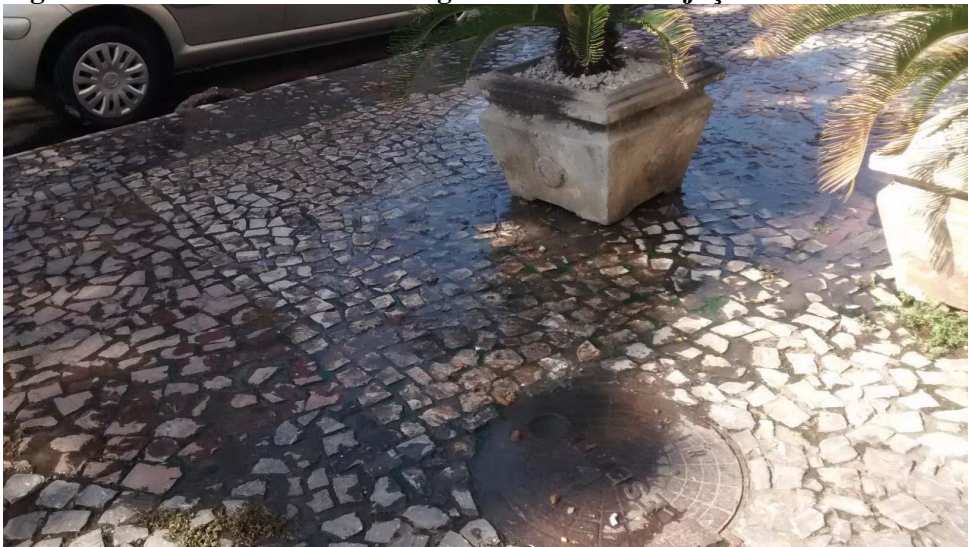
Figura 9 – Transbordamento de esgoto na Bacia da Pajuçara.
